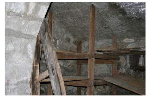
Vue intérieure de la cave d'affinage
