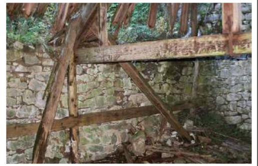
Partie effondrée sur le premier bâtiment
